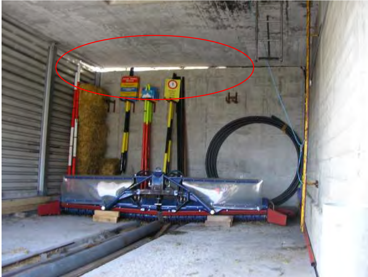
Deformation Gipfelseilbahn (Gemsstock, Andermatt, CH)
